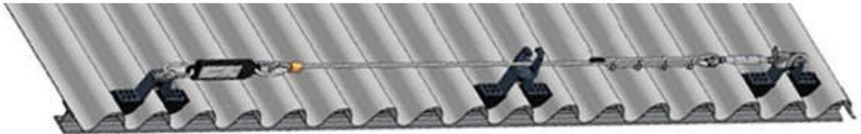
Línea de vida de cable de “paso corto” sobre soporte estructura metálica bajo cubierta de fibrocemento
